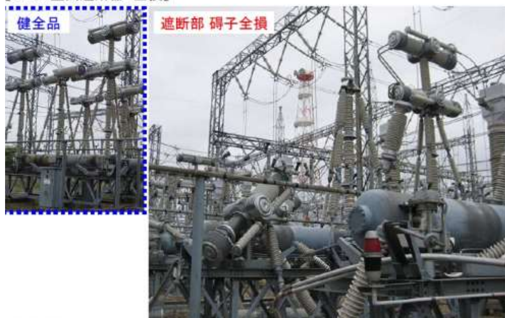
図 4 福島第一原発変電設備の被害状況
