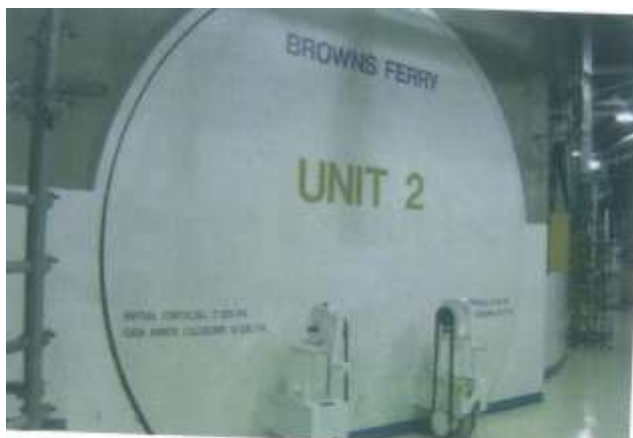
図 19 非常用発電機室の防水扉（ブラウズフェリー原発）甲 38
