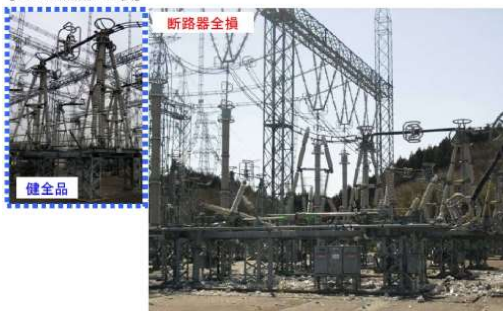
図 5 福島第一原発変電設備の被害状況
