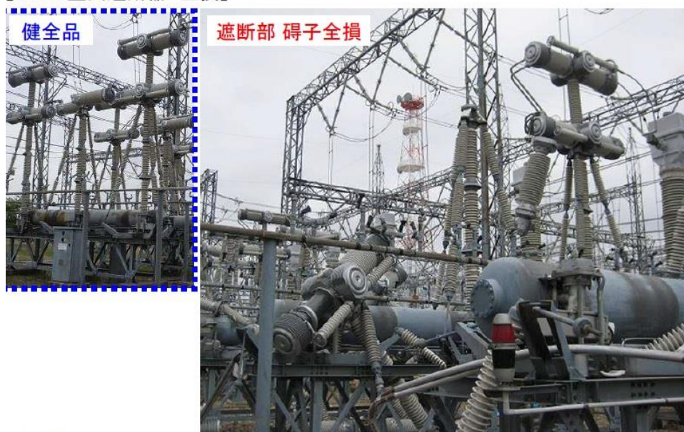
図 2 福島第一原発変電設備の被害状況
