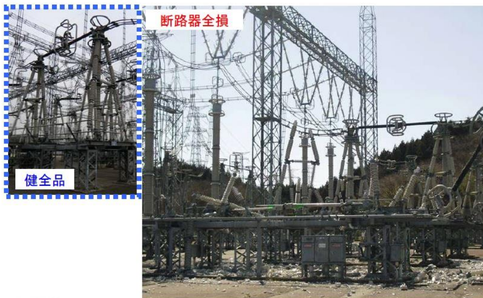
図 3 福島第一原発変電設備の被害状況
