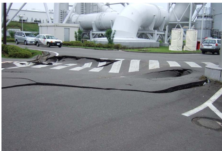
原発敷地内で生じた地割れ
