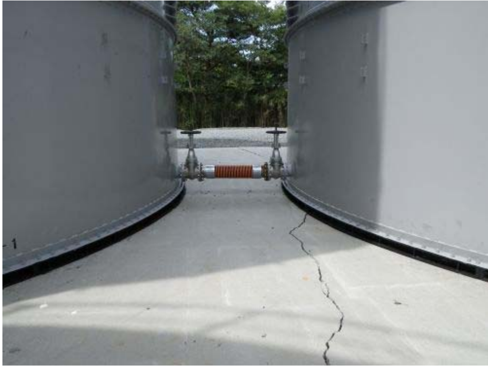
(東京電力撮影 2011年7月 タンクの基礎にひび割れが発生している。このため、タンクは移設された。)
