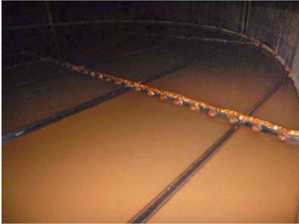
(2013年7月 東京電力撮影 漏洩が起きたタンク内 ボルトが確認できる。)
