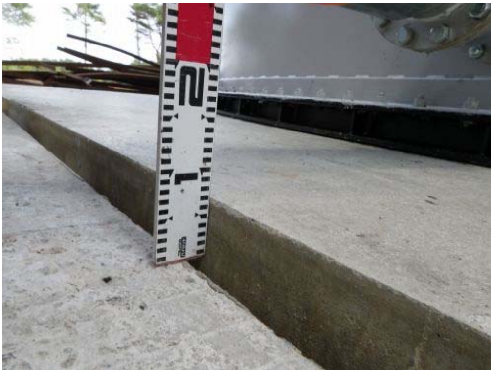
(東京電力撮影 2011年7月 地盤沈下している)
