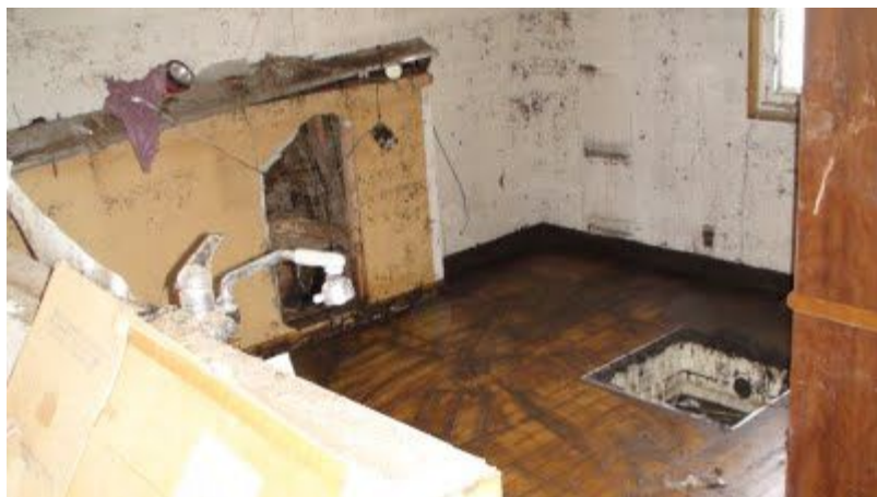
(写真 16) 瓦礫撤去後の住宅内の一部です。
