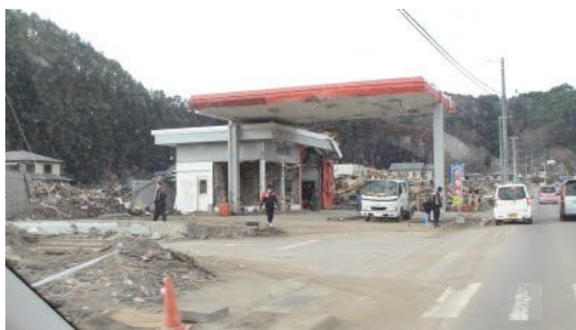
(写真 32) この地域で津波の被災の最も強かった沿岸部のガソリンスタンド。
