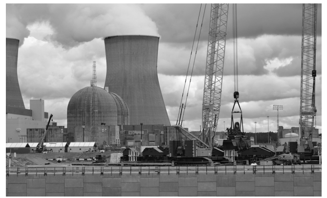
ボーグル原子力発電所サイト。左奥が運転中の1、2号機。手前が4号機の建設現場。
