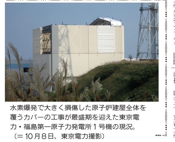
水素爆発で大きく損傷した原子炉建屋全体を覆うカバーの工事が最盛期を迎えた東京電力・福島第一原子力発電所1号機の現況。(=10月8日、東京電力撮影)
