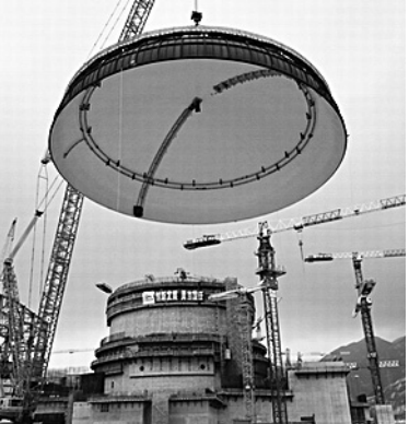
重さ 240 トンの鋼製丸天井は地上 70 メートルまで吊り上げられ、高さ 44 メートルの円筒状建屋の上部に設置。今後は全長 147 メートルの外周を溶接する計画だ。（©中国核工業華興建設）
